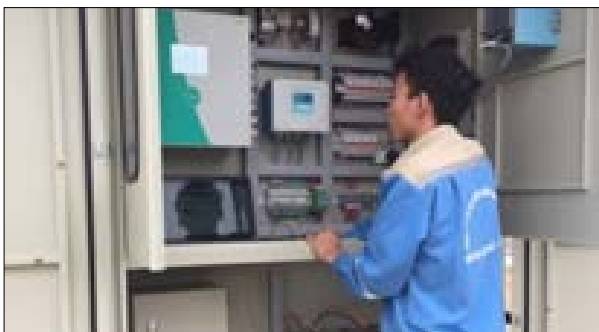
▲ Hệ thống quan trắc nước thải tự động
