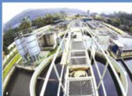
Trạm xử lý nước thải mỏ Vàng Danh - Công ty TNHH MTV Môi trường - TKV
