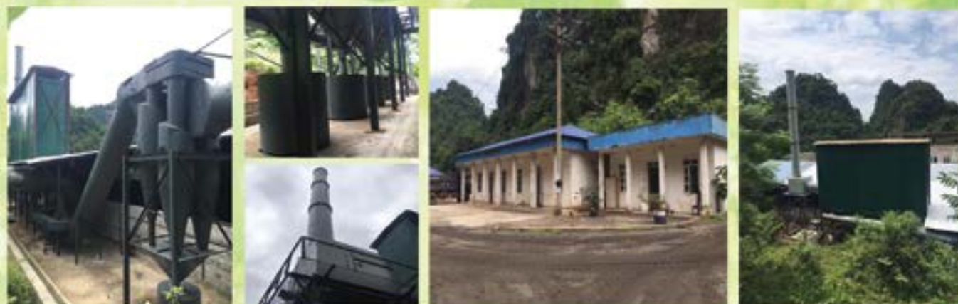
Hệ thống xử lý khí thải lò luyện Feromangan của Công ty cổ phần Khoáng sản NIKKO Việt Nam
